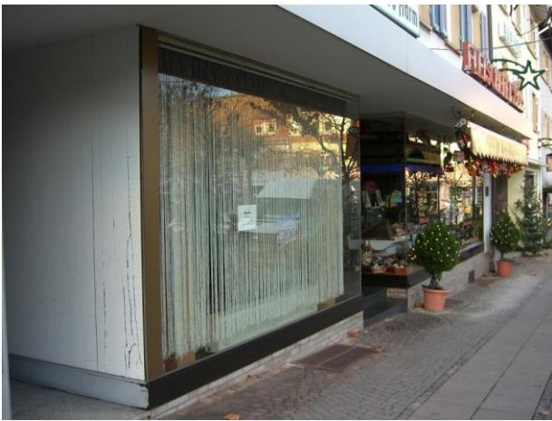
Alte Schaufenster: Nicht nur undicht und defekt, sondern auch echte Energieschleudern
